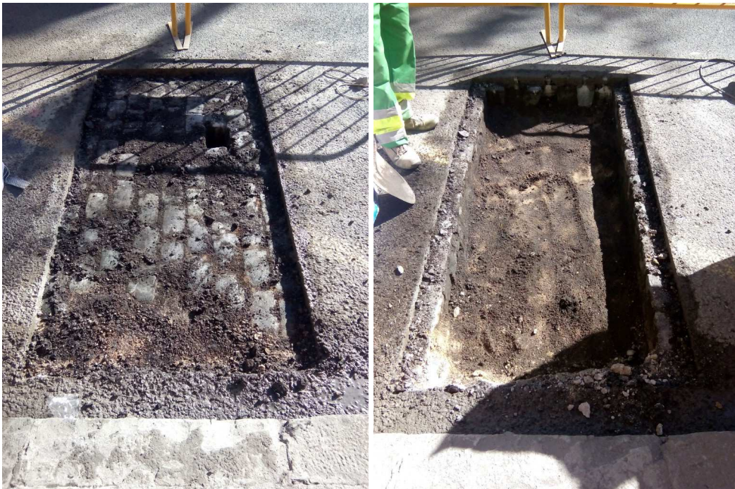
Vista de la pavimentació de llambordes i la preparació de sorres localitzada a les cales 3 i 4.
